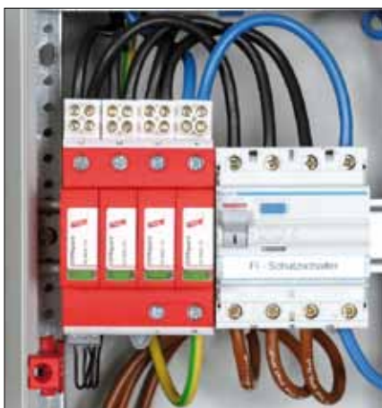
Obr. 1. Svodič přepětí DEHNguard M před proudovým chráničem
