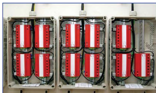
Příklad použití DEHNlimit PV 10000 pro ochranu měniče
