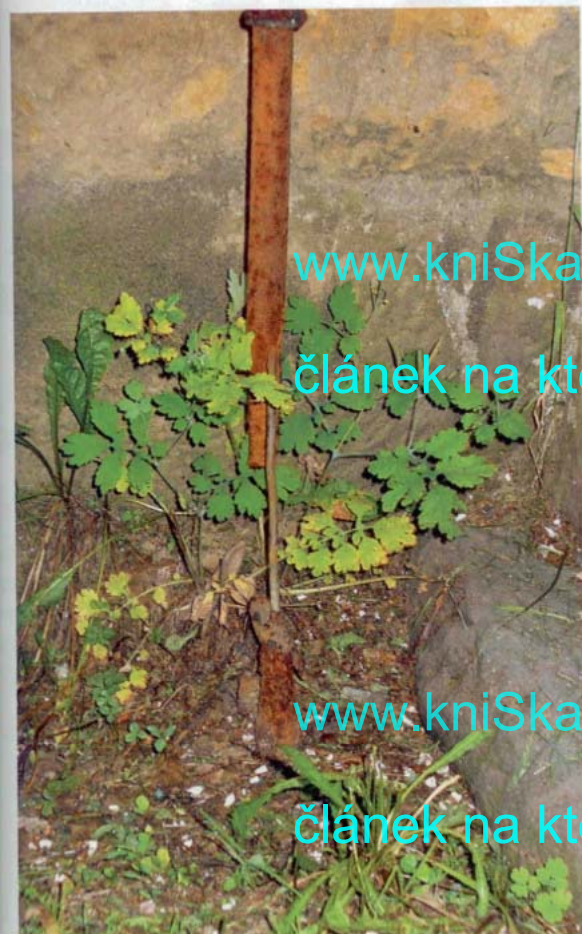
Největším nebezpečím hromosvodů bývá koroze. Proto se doporučuje každých pět let pravidelná revize (DEHN+SÖHNE)
