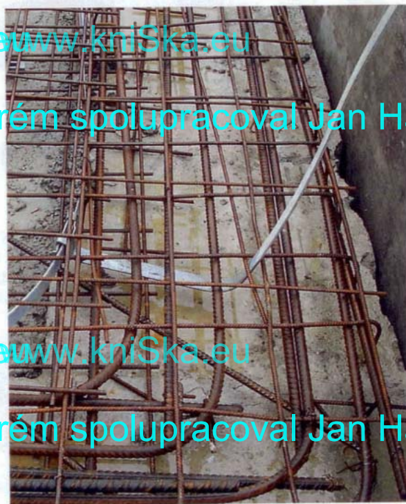
Pro funkci hromosvodu lze dobře využít i armovací síť. Dokud je nekryje beton...
