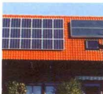
Auf diesem Dach ist links eine Photovoltaikanlage (PV-Generator mit monokristallinen Modulen) zur Stromerzeugung montiert, rechts sind zwei Solarkollektoren zur Warmwasserproduktion installiert.
